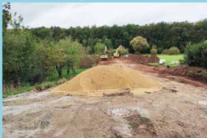
Am Ortsrand unserer Gemeinde in Richtung Ritzmannshof wird eine Maßnahme zur Entwässerung durchgeführt
