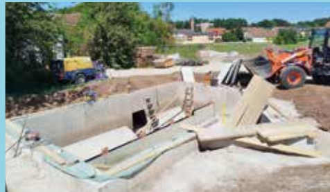
Im Zenngrund wird der Stauraumkanal erneuert, um eine ordnungsgemäße Entwässerung für Siegelsdorf zu sichern
